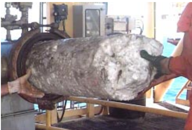
6 Газогидратные пробки в трубах
